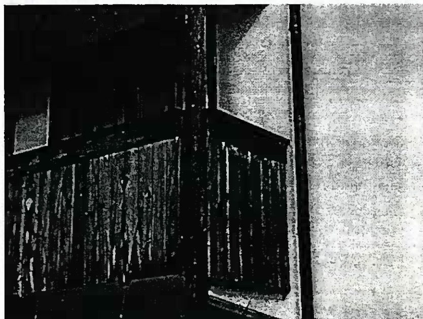
Bild 6.4-1 Folgen von Bewitterungsein- flüssen bei unbehandelten Balkonbrettern [Foto: Trübswetter]
